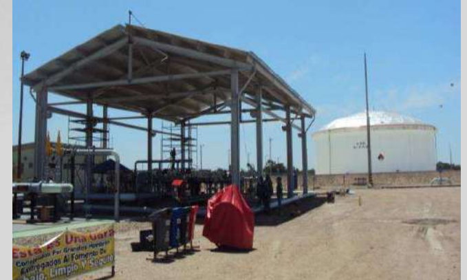
CASETA PATIN DE MEDICION ESTACION APIAY - ECOPETROL
