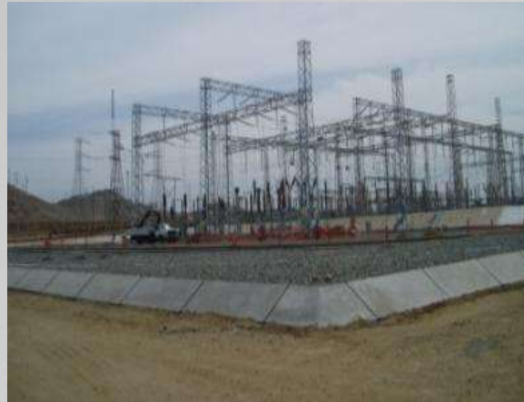
SUBESTACIÓN CHICLAYO PIURA AMPLIACION 6 230/115 KV – LIMA PERU
